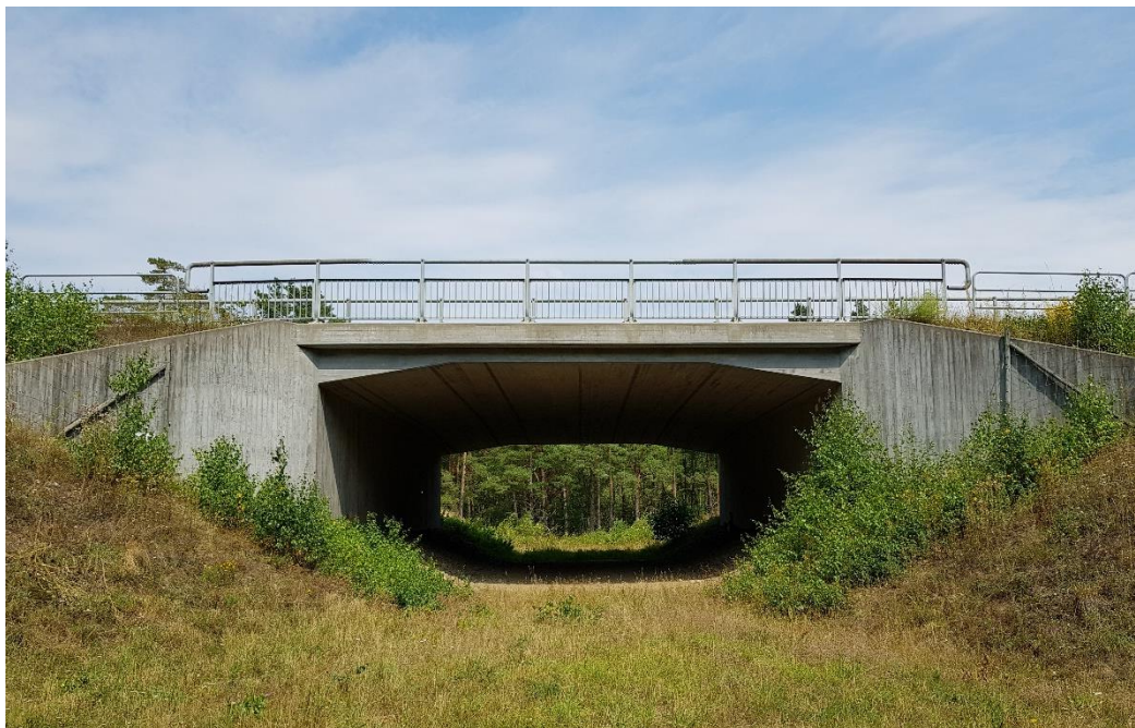
Faunaporten vid Vomb före anläggning av faunaskärmar.
