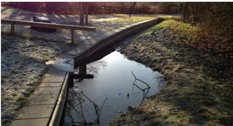
Figur 19. Vattensamling utanför norra tunnelns västra mynning vid besiktningen den 26 februari. Foto Johanna Lundberg, Calluna.
