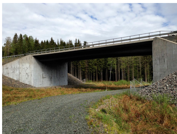
Fig. 4. En bred så kallad faunaport under riksväg 31 mellan Jönköping och Nässjö, samlokaliserad med en bommad skogsbilväg. Foto: Mattias Olsson/EnviroPlanning AB
