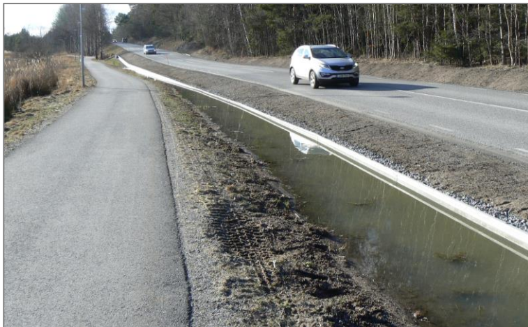
Bild 14. Vattenansamling på södra sidan Stavsnäsvägen. Vattnet stod upp till ca 5 cm från ledarmens överkant/överhäng. 2016-03-30.
